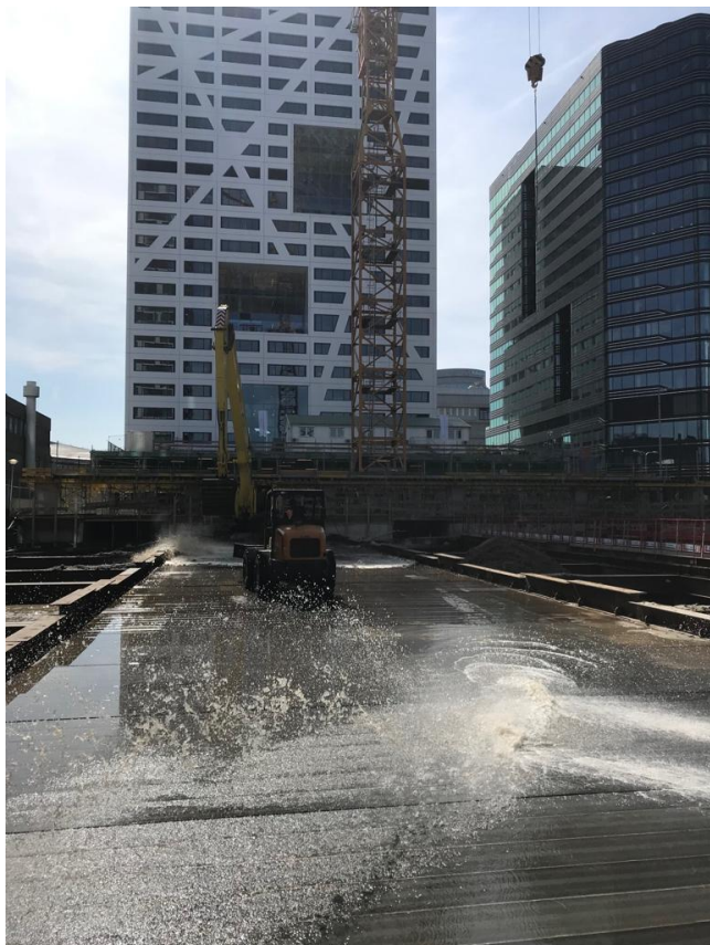
Afbeelding 3: De werkbrug van dichtbij. Op de voorgrond de waterstralen van de sproei installatie, die zorgt voor het schoonhouden van de vrachtwagens.
